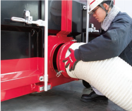
ダクトホース接続
